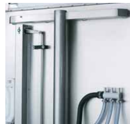
Steigleitungen ausserhalb der Waschkammer in robuster CrNi-Stahlausführung.
